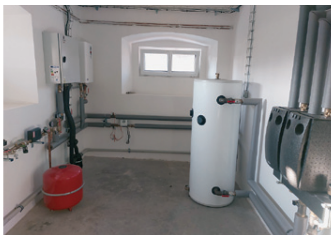
Technologie TČ ve sklepních prostorách MŠ.
