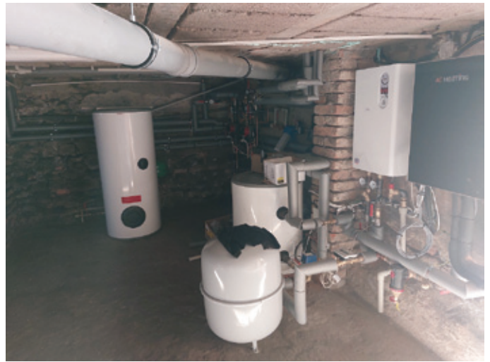
Technologie TČ ve sklepě budovy.
